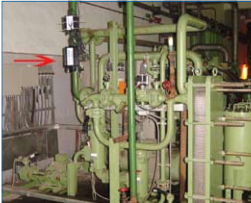
Гидрофлоу на блочном тепловом пункте
