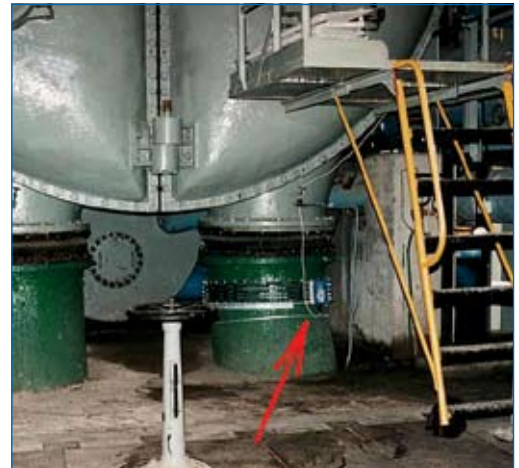
Гидрофлоу на конденсаторе турбины
