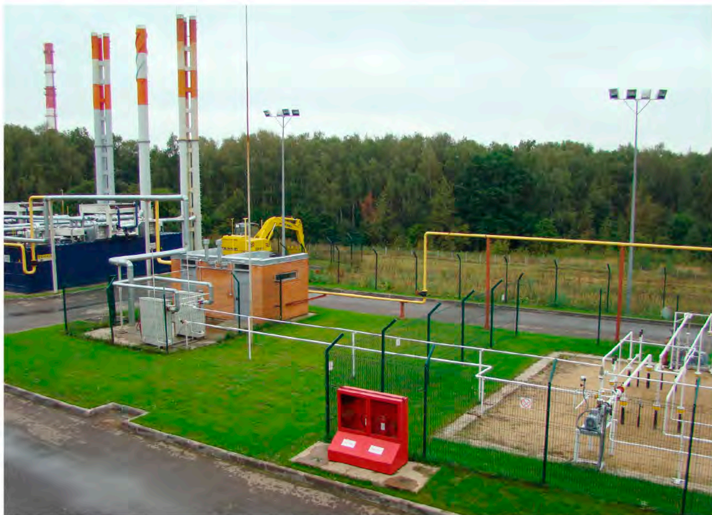
Газопоршневая мини-ТЭЦ, построенная и работающая в г. Пушкино (Московская обл.)
